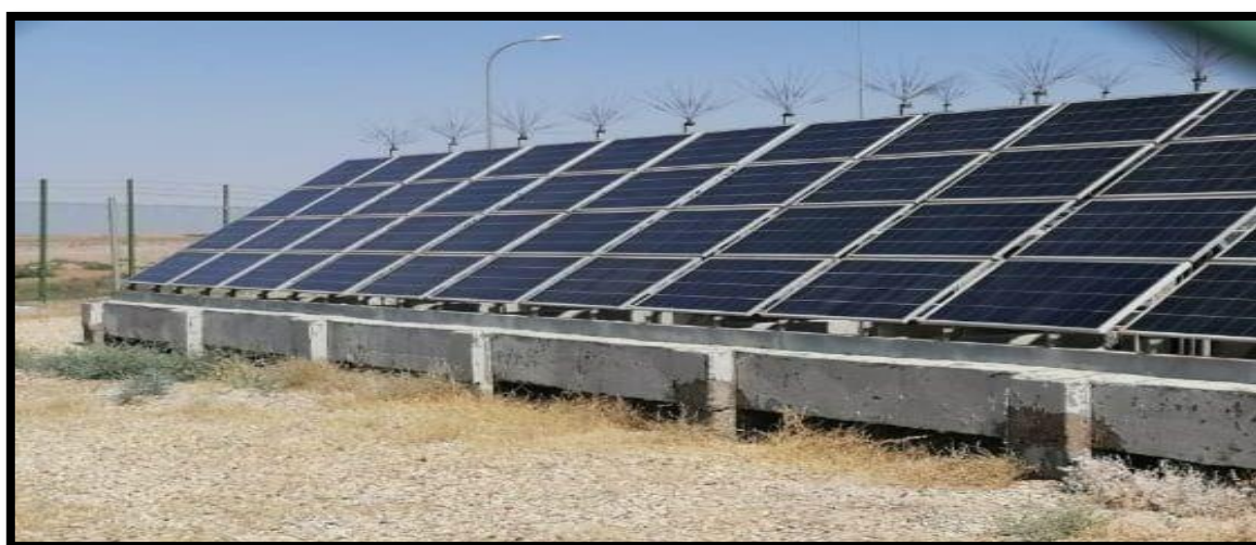
صورة (1) الألواح الشمسية وتوربينات الرياح التي تعمل على توليد الطاقة الكهربائية في شرق محافظة واسط
