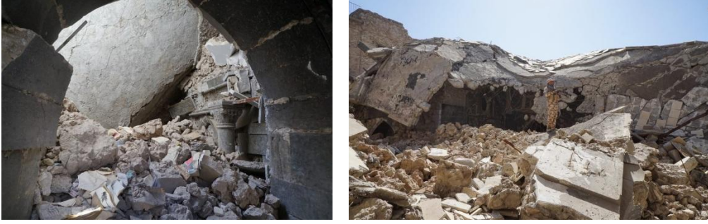
انهيار السقف وركام المبنى نقلاً عن: (زكريا هاشم وآخرون، ٢٠٢٤، ٢٨ / ١٣٩)
