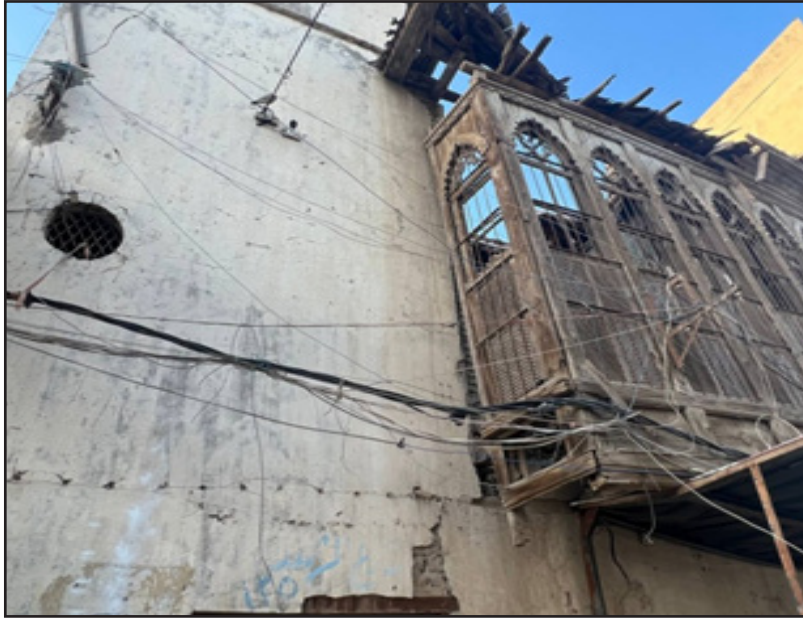
شكل رقم (27) سقوط الشناشيل من الجهة اليسرى (تصوير الباحث 2023).
