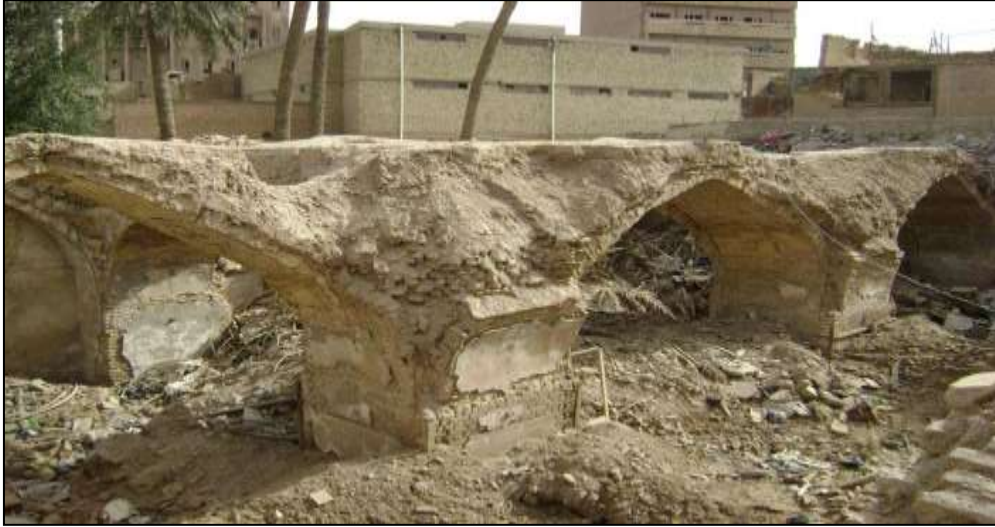
(الصورة - ٦) بيت الصلاة مهدم
