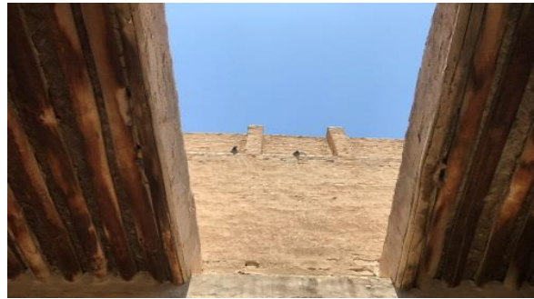
شكل (١٥) سقف حجرة المرافق الصحية المفتوح
