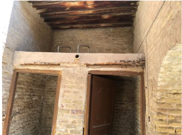
شكل (١٦) المرافق الصحية سقفها اخفض من سقف الحجرة
